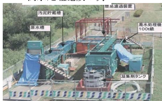
濁水処理施設の例
